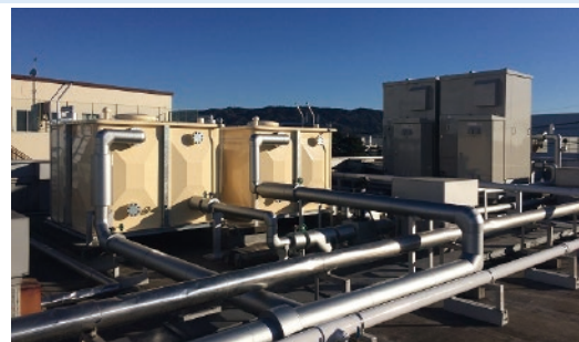
設置された地中熱ヒートポンプシステム
