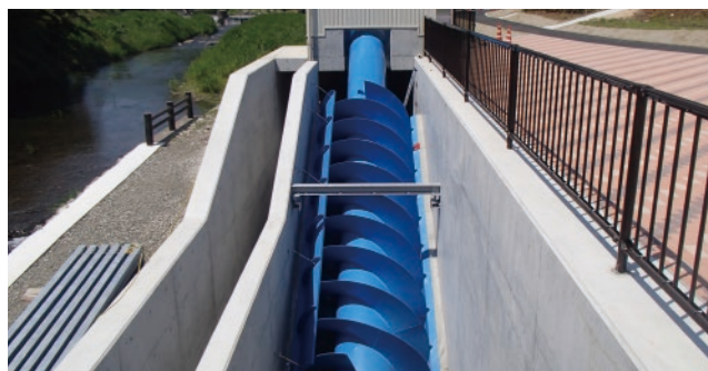
小鷹井堰に設置されたらせん水車
